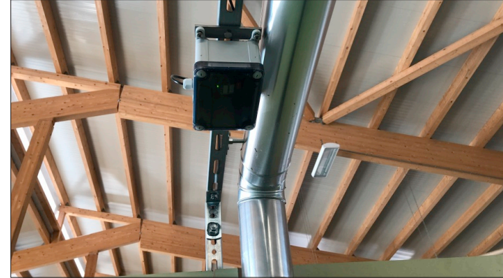
Der Sprühdüsen-Sensor befindet sich oberhalb der Anlage und aktiviert sich bei Bewegung.
